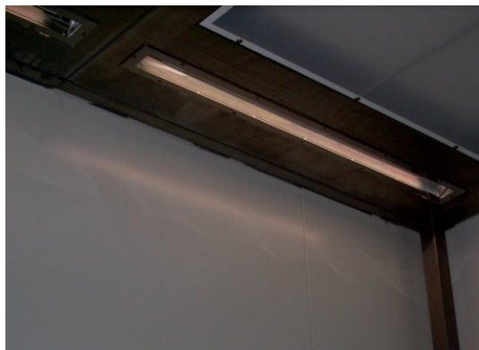
Einbauleuchten mit Glasabdeckung
